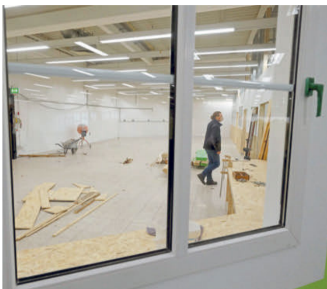
Auch beim eigenen Umbau wird auf Nachhaltigkeit gesetzt. Die Fenster stammen aus der Kaserne auf dem Stiftberg.
